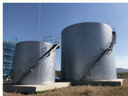
バイオマス燃料貯蔵タンク (現地組み)
