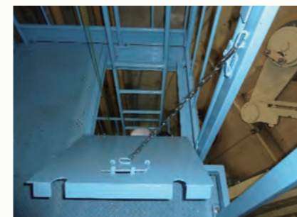
発電所内安全階段
