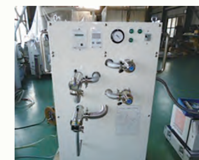
真空ポンプユニット
